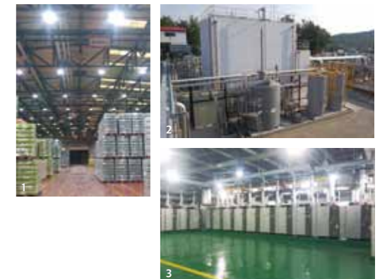
1 여주공장 창고 조명기기 LED전등으로 교체 2 여주공장 혐기성처리시설 설치 3 여주공장 관류 보일러 전경
