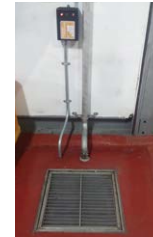
광주공장 유독물 저장시설 방호벽 주위 트랜치 및 배수설비
